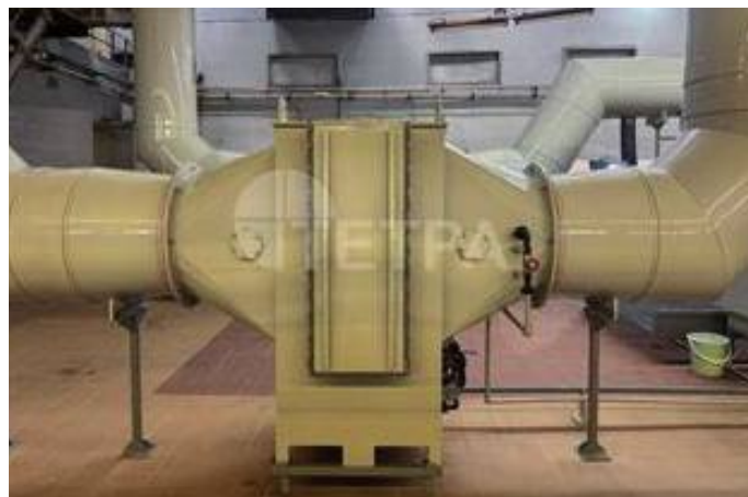
Фото фильтра в работе на гальванической линии.
