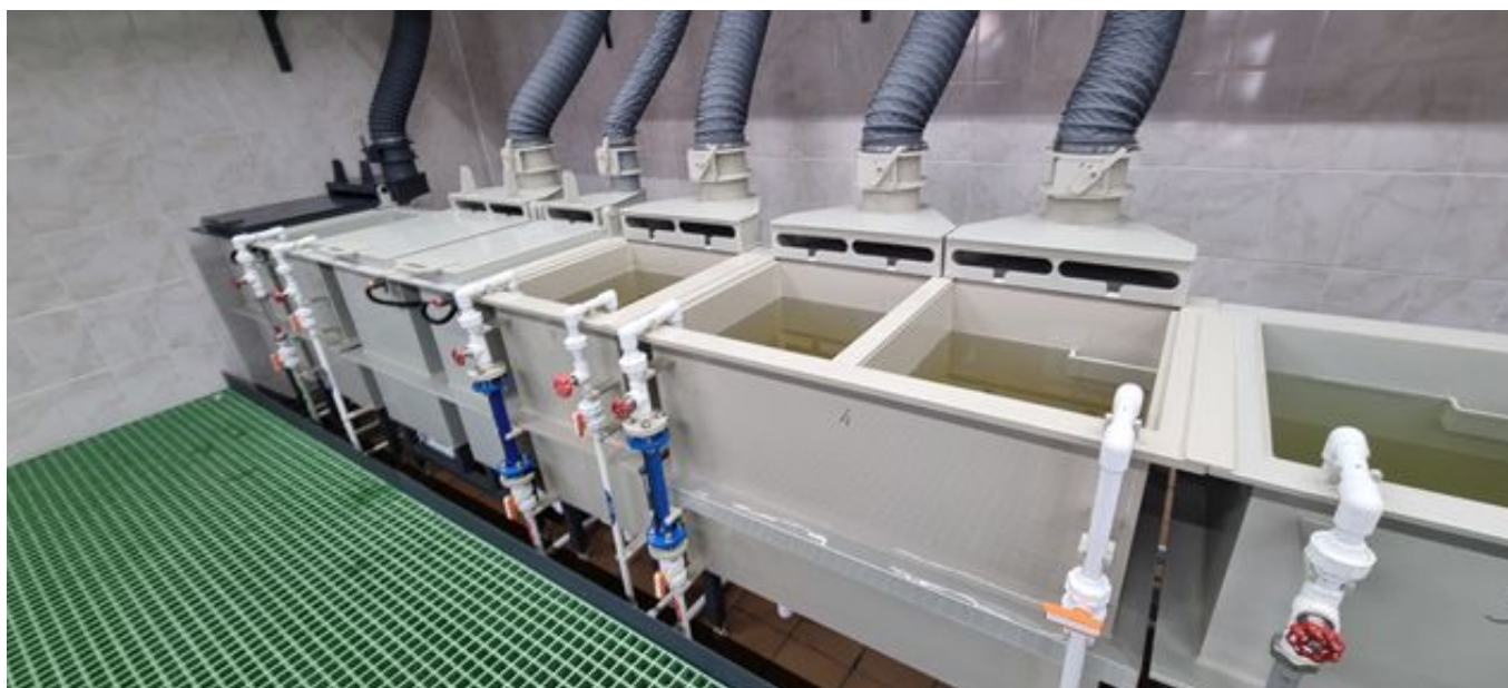
Гальванический участок после модернизации, проведенной ООО «ТЕТРА»
