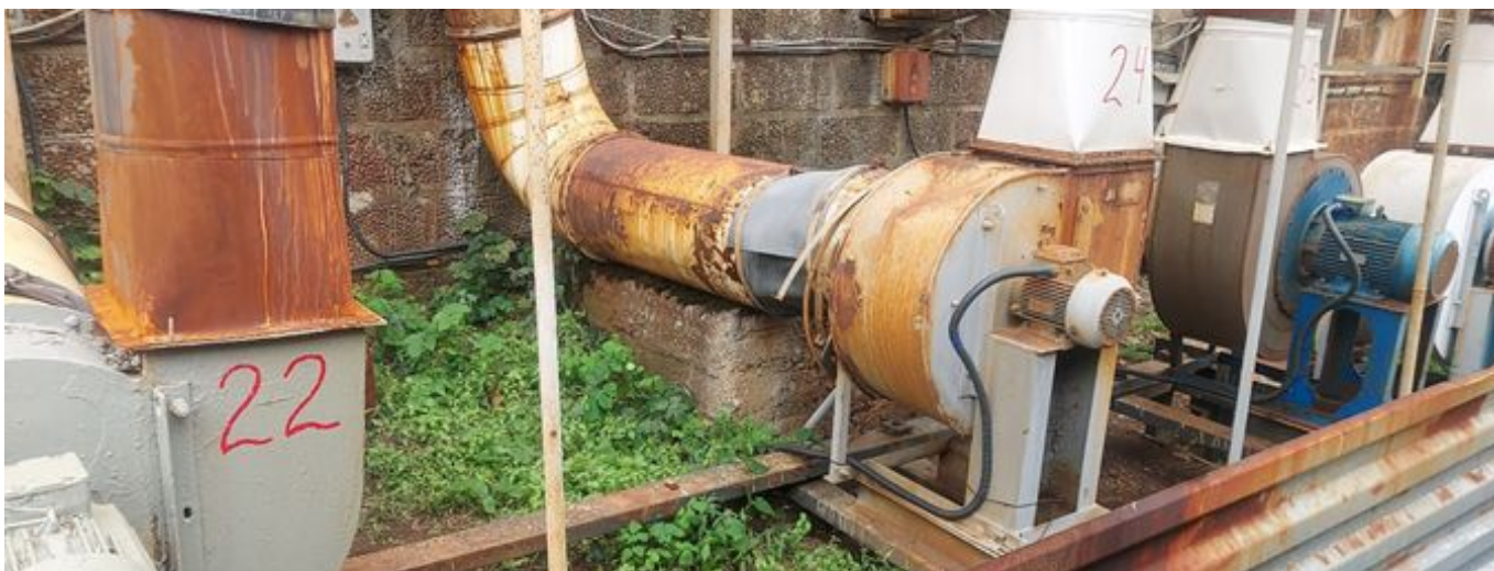
Система вентиляции до модернизации
