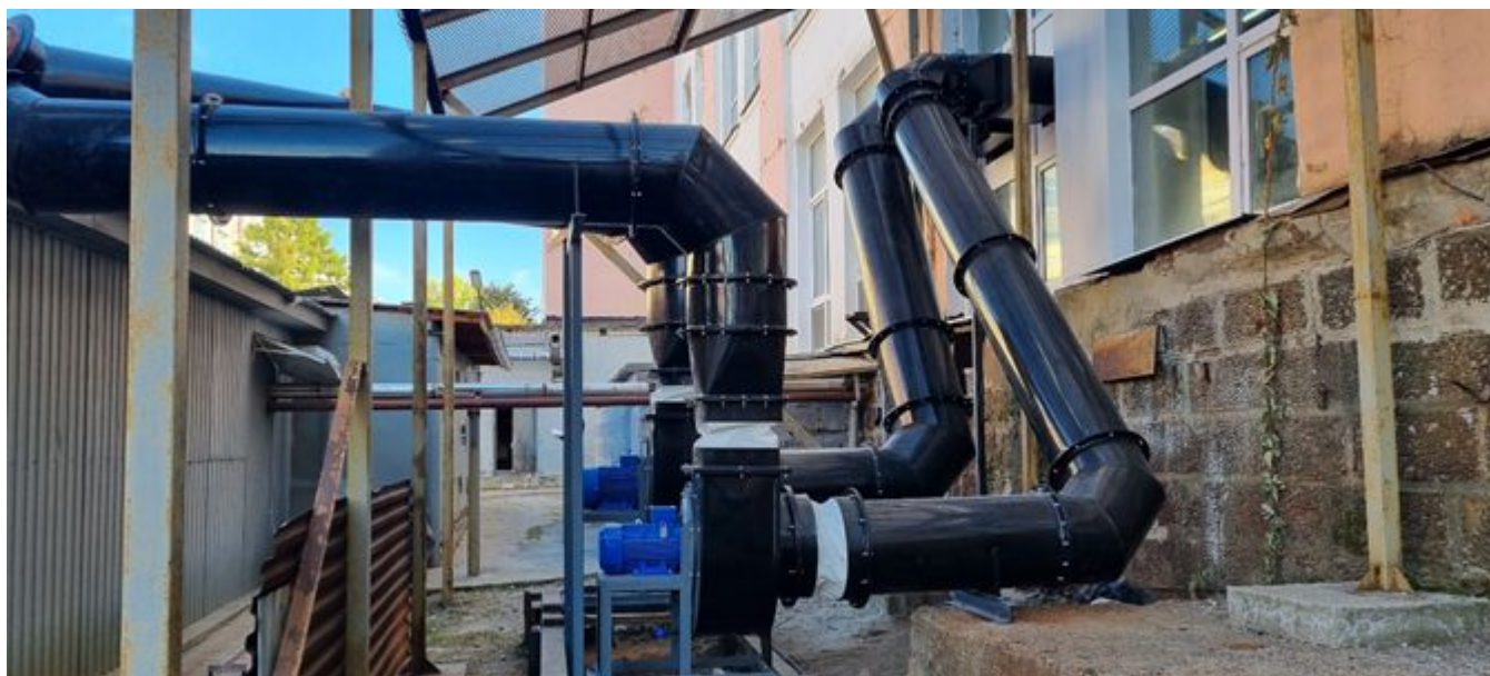
Система вентиляции после модернизации
