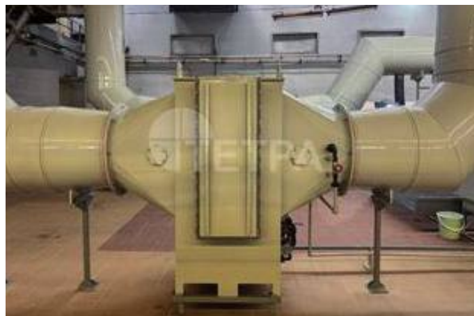
Фото фильтра в работе на гальванической линии.
