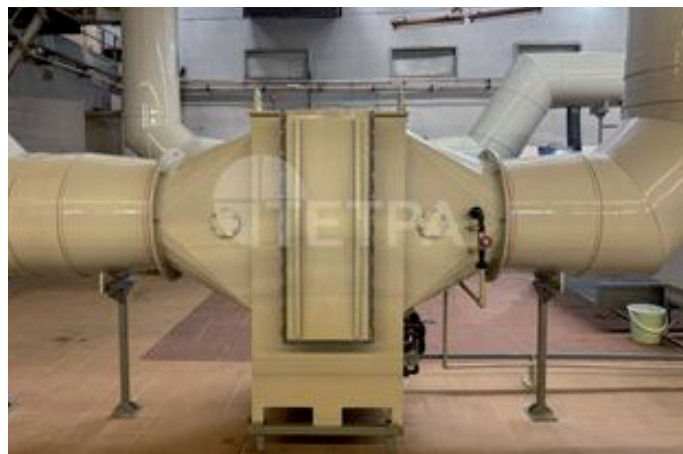
Фото фильтра в работе на гальванической линии.
